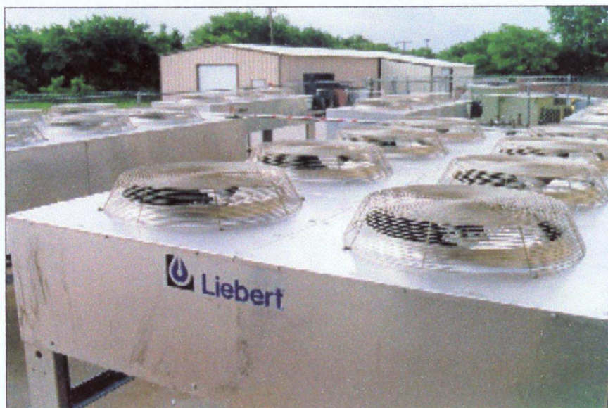
圖 34 風冷乾式冷卻塔
