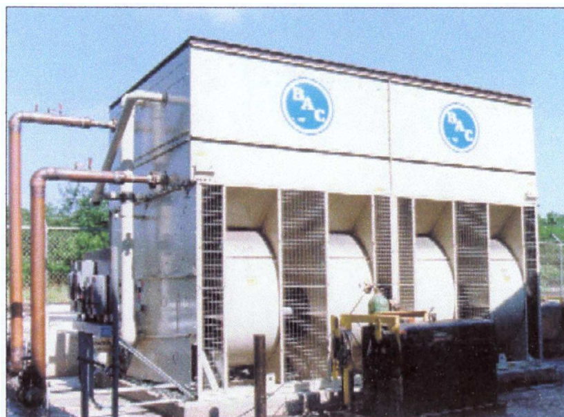
圖 33 密閉式工業用冷卻塔
