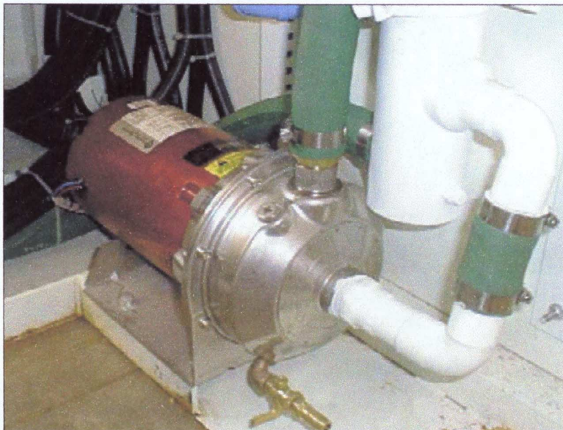
圖 36 內水不銹鋼泵浦組
