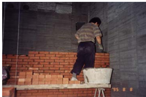
圖 15 新砌磚牆經常有砂漿溢出 粉刷前必須先打除
